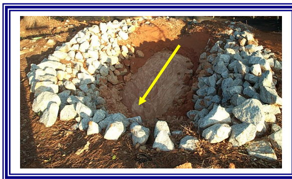
Rock Sediment Dike
