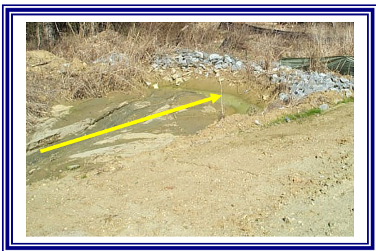
Rock Sediment Dike
