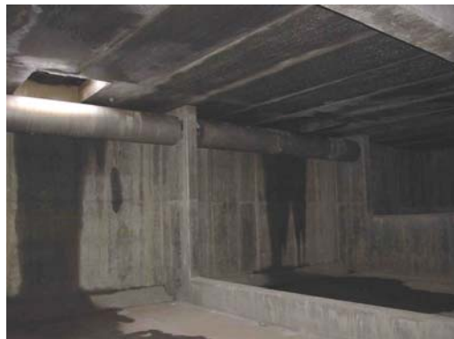
Detalle tanque retención con dos limpiadores
