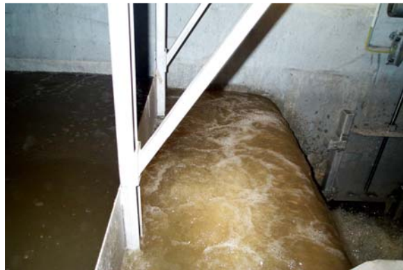
Tamiz en funcionamiento. El nivel de agua es tal que es necesario aliviar a través de la rejilla al medio receptor.
