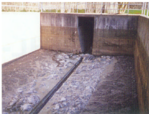
Fig 1. Sedimentación en Tanque de Tormentas
