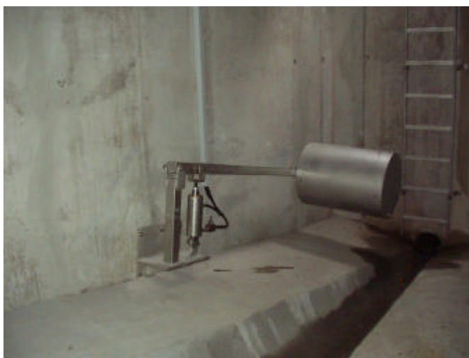
Vista del flotador de control
