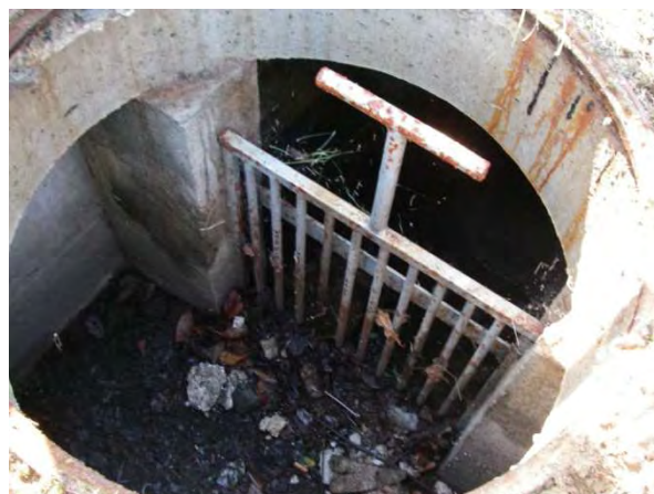
Entretien de l'ouvrage de régulation
