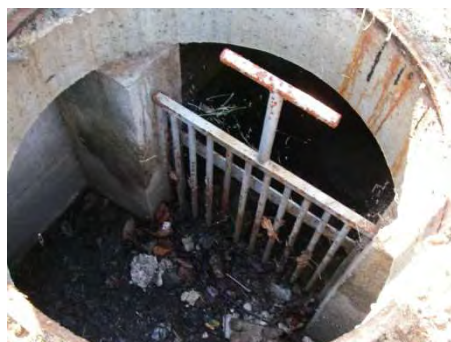
Entretien de l'ouvrage de régulation
