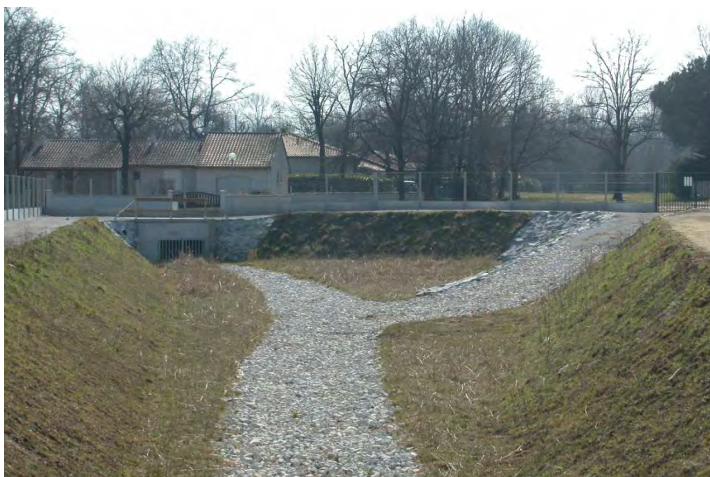
Bassin Lagorce Rue de Grattecap à Blanquefort
