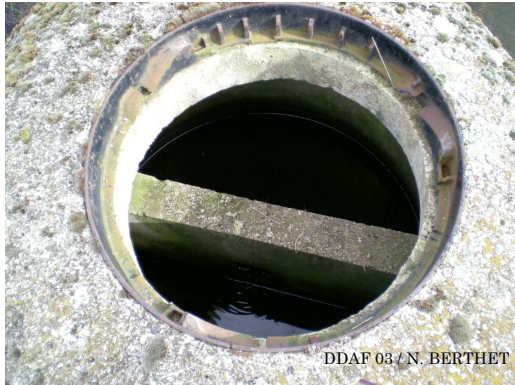
Figure 9 : Séparateur à hydrocarbures
