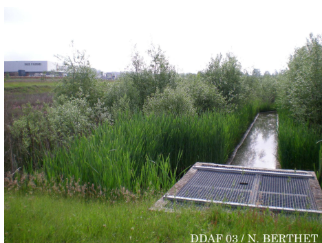
Figure 5 : Collecteur / dégrilleur EP
