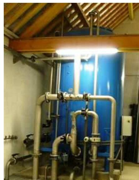
Cuve de traitement à CAG
