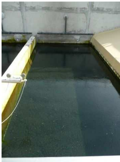
Nemours – Filtre avec traitement biologique
