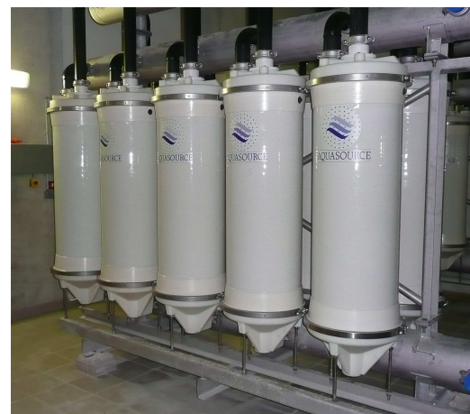
Modules de filtration membranaire
