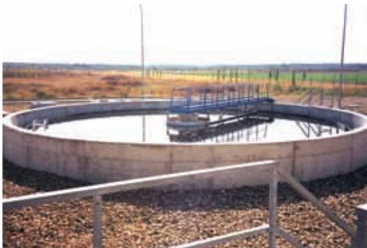
Foto 5.22. Decantador Secundario. EDAR de El Rocío (Huelva).
