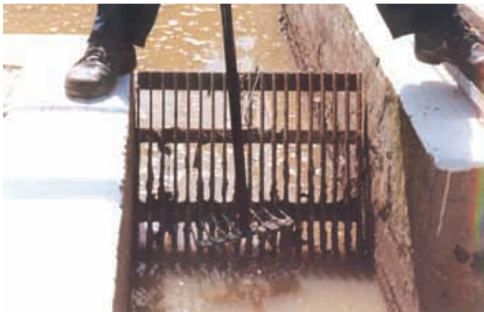
Foto 5.3. Limpieza manual de las rejas de desbaste.
