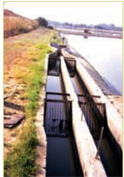
Foto 3.3. Canal de desbaste. EDAR de Almonte (Huelva)
