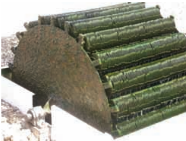
Foto 5.20. Detalle de Contactor Biológico Rotativo.
