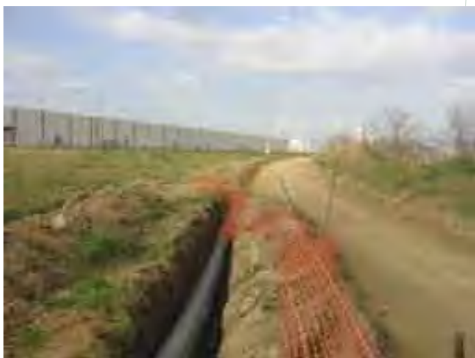
Tuberías para la conducción del agua
