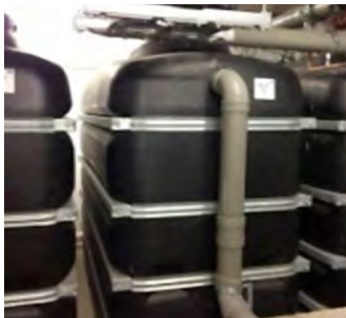
Sistema de aprovechamiento de agua de lluvia en Coventry (Reino Unido).
