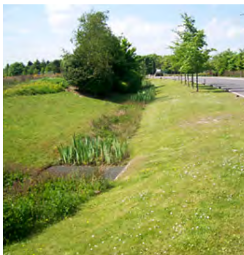
Franja filtrante que conduce el agua a una cuneta vegetada en Escocia.
