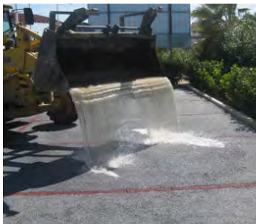
Pavimento permeable en Benaguasil (España).
