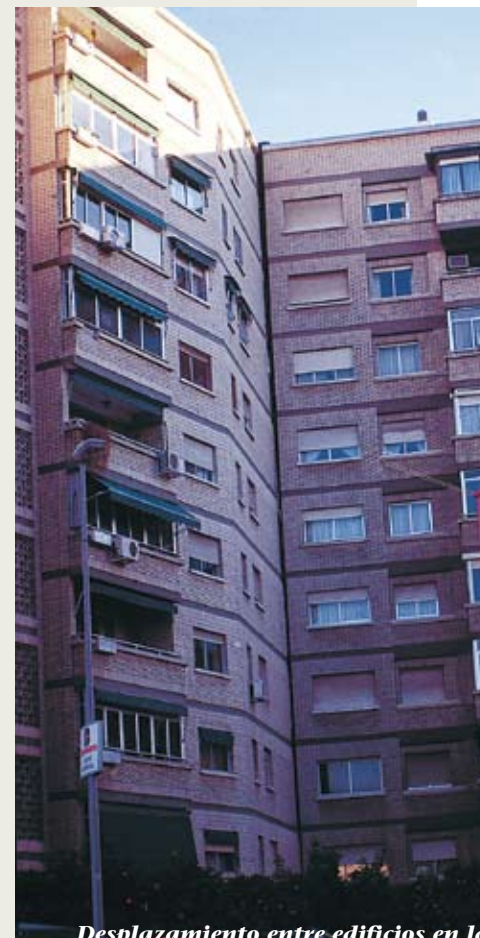
Desplazamiento entre edificios en la ciudad de Murcia como consecuencia de fenómenos de subsidencia del terreno a causa del descenso piezométrico
