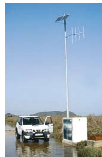
El control de un sondeo puede hacerse a través de sistemas de seguimiento remoto alimentado por energía solar
